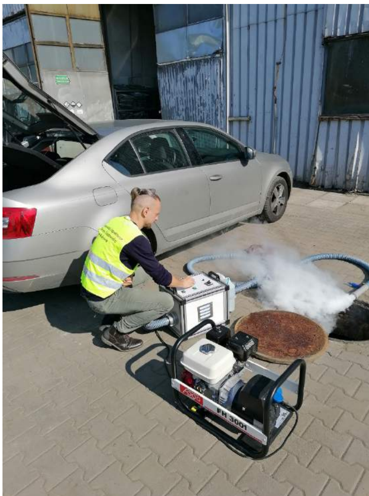
Fot. nr 3. Inspektor w trakcie działań polegających na zadymianiu kanalizacji opadowej na terenie zakładu PLAST MM ADRIAN PEKALA, Ofiar Oświęcimia 55A, 32-620 Brzeszcze (Brzeszcze, dnia 8.10.2021 r.)
