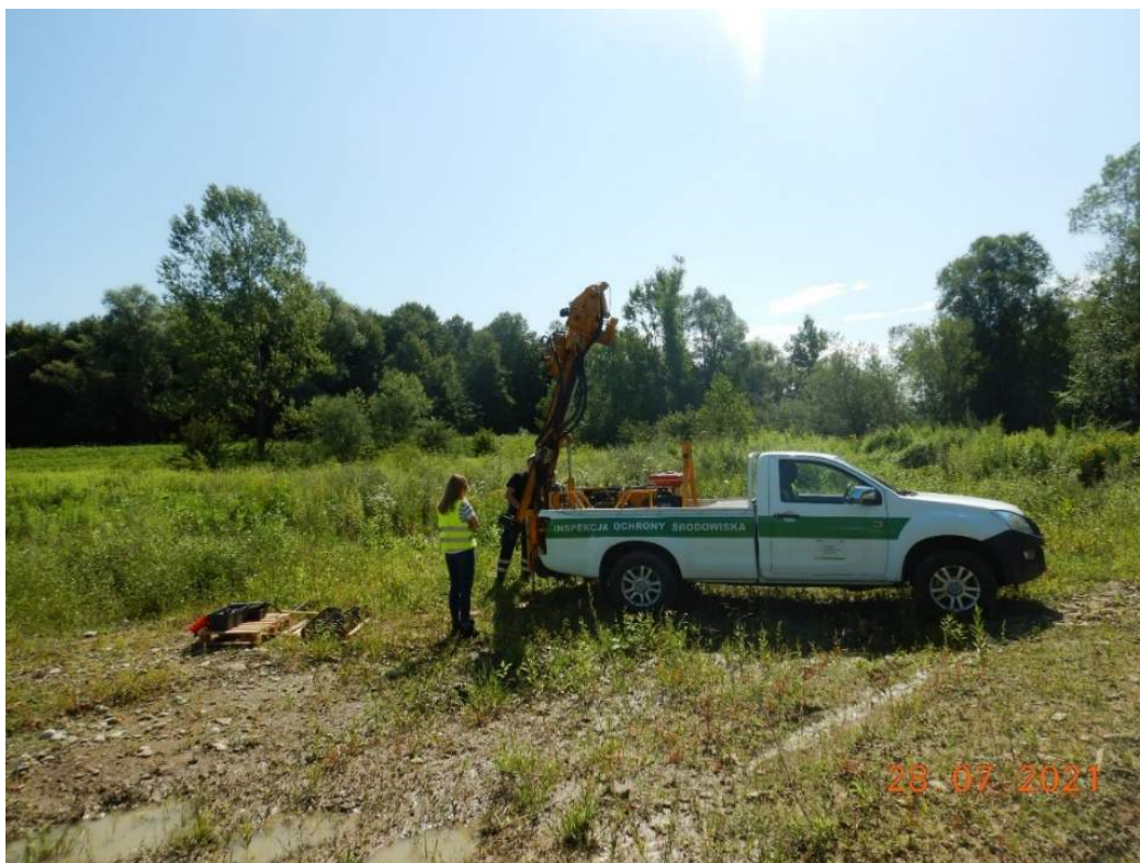
Fot. nr 8. Użycie wiertni podczas kontroli na terenie przylegającym do rzeki Dunajec w Nowym Sączu gdzie w nielegalnych wyrobiskach żwiru zostały zdeponowane zmieszane odpady budowlane, 28.07.2021 r.
